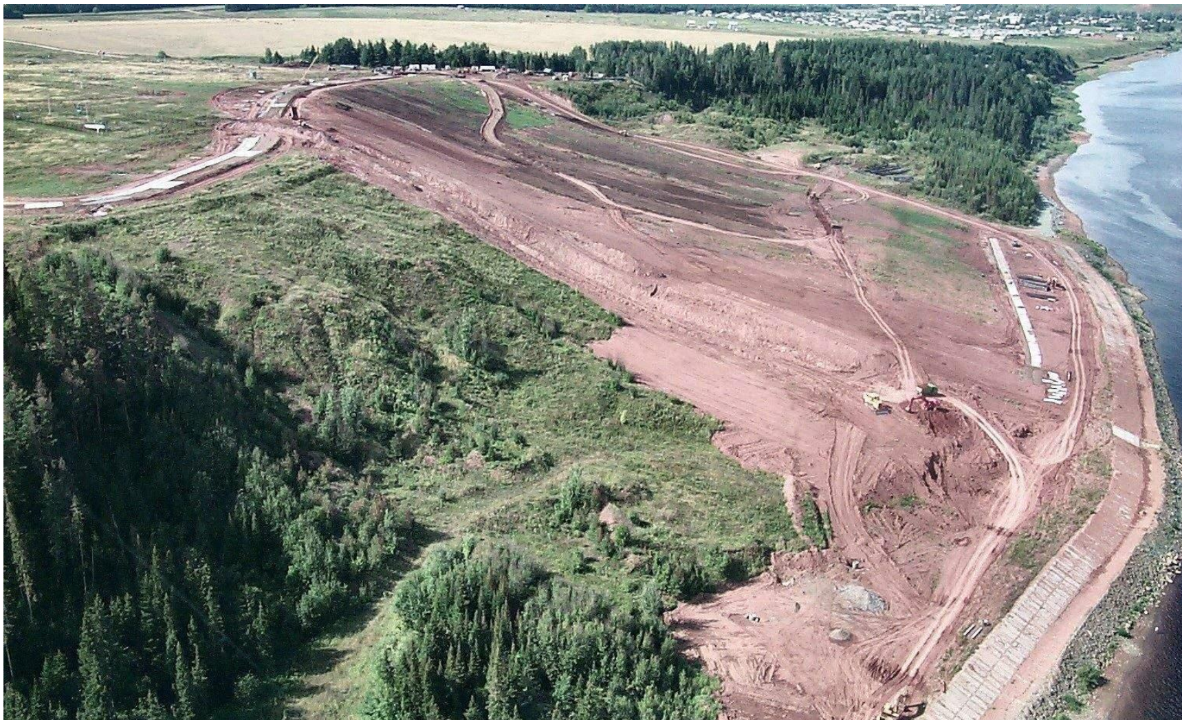
Вид оползневого склона с Южной стороны
